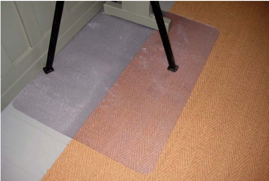
Bild kyrka 2.4: Plastskivan under ljusbäraren ger inget brandskydd!
