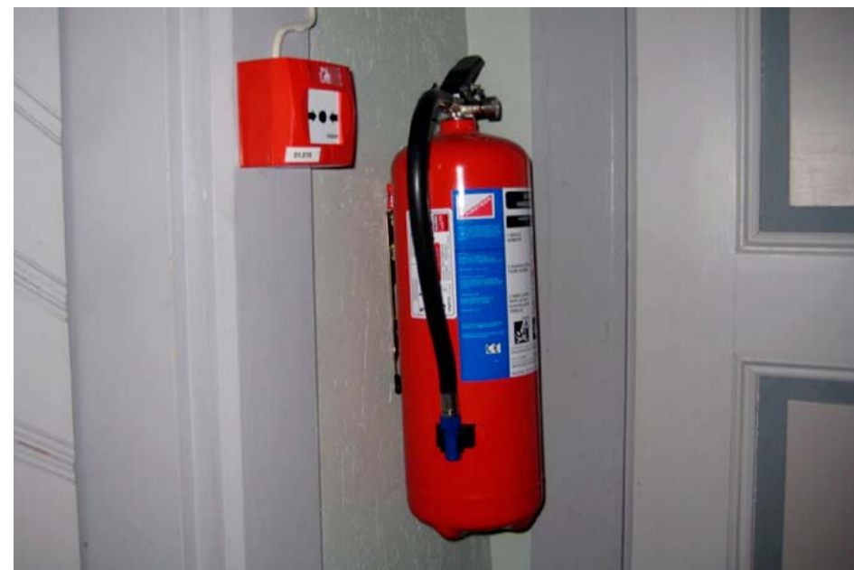
Bild kyrka 5.4: Handbrandsläckare samt alarmtryckknapp.
